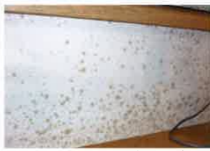
リフォーム前のAさんの塗り壁。水分の 吸収と放出ができないうちにカビが生える
